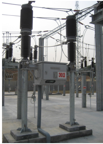
(AEVK I 2×27.5 kV 福厦客运专线)
